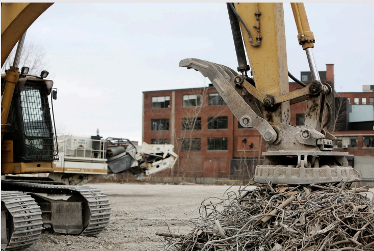
Electroimán en una excavadora
